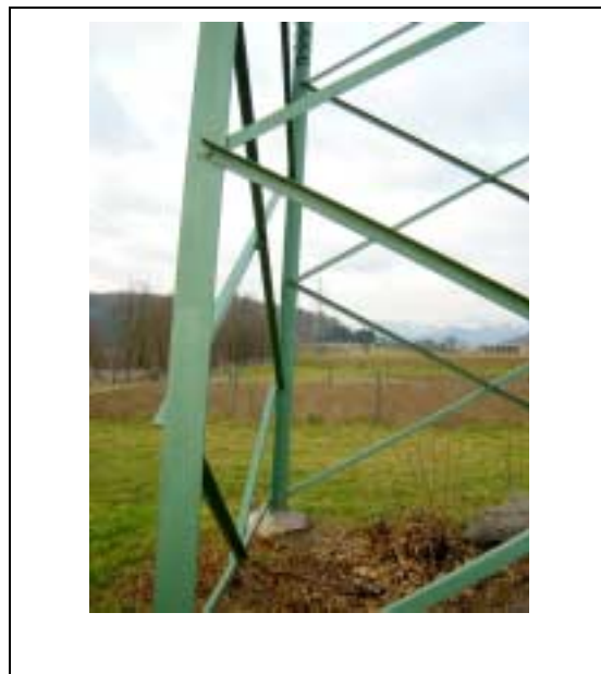
Steber visokonapetostnega električnega voda
