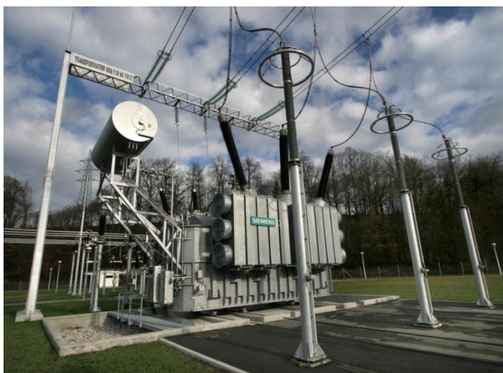
Slika 304: Slika velikega transformatorja
