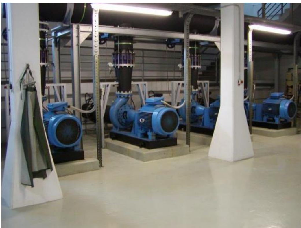
Črpalke za oskrbo s pitno vodo
