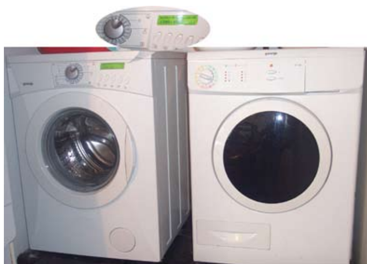
Priprava pralnega stroja za pranje perila in sušilni stroj. Nastavitvena temperatura na pralnem stroju je 95 °C.
