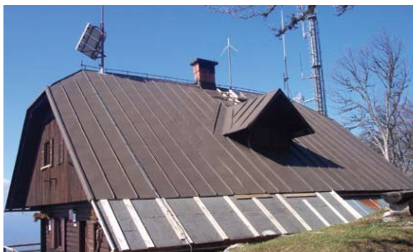
Hiša s strelovodom.
